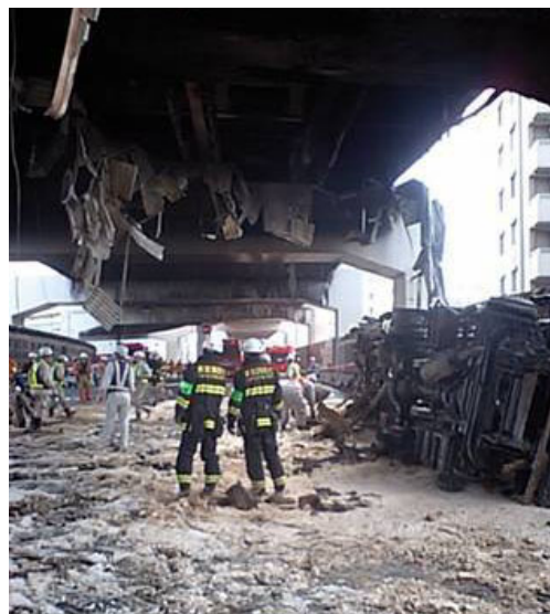
写真－2 損傷状況
