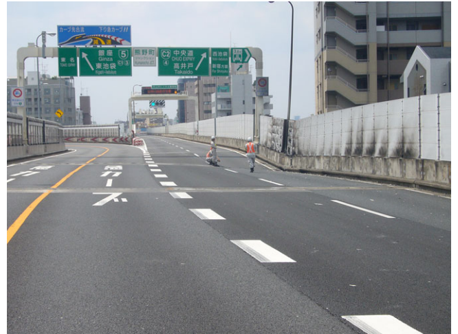
写真－3 上層路面沈下状況
