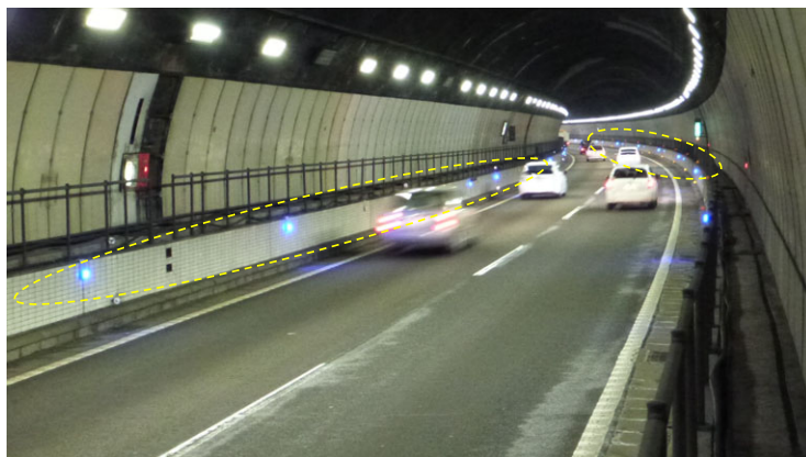
図 5 福島トンネル内の設置状況
