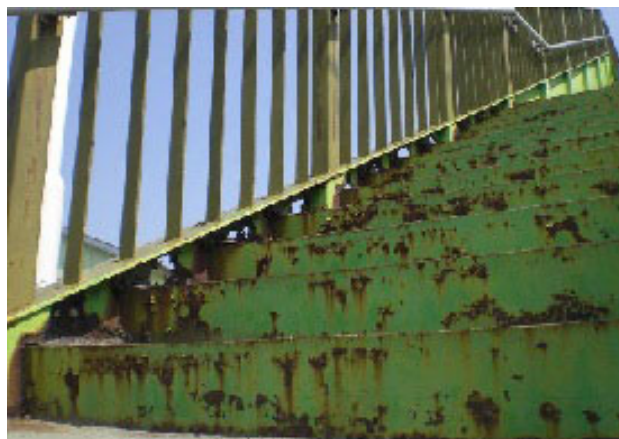
▲写真－5 横断歩道橋の損傷状況
