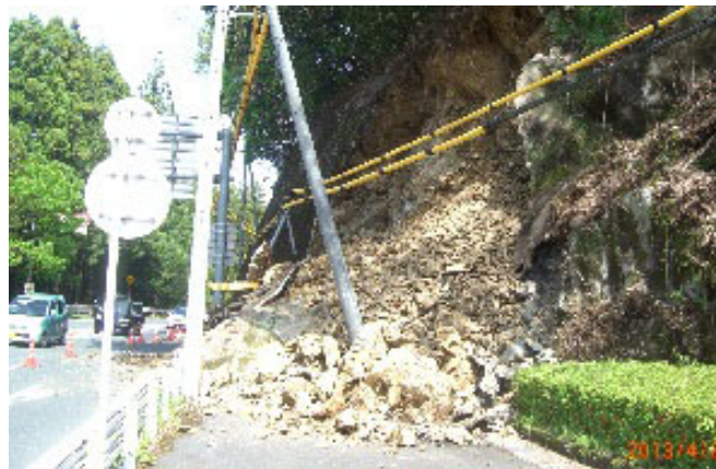
▲写真－6 吹付け法面の崩落現場
