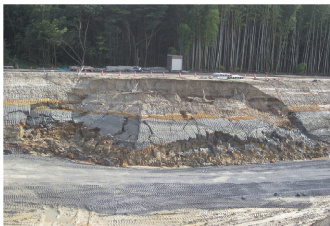
土砂崩れ状況
