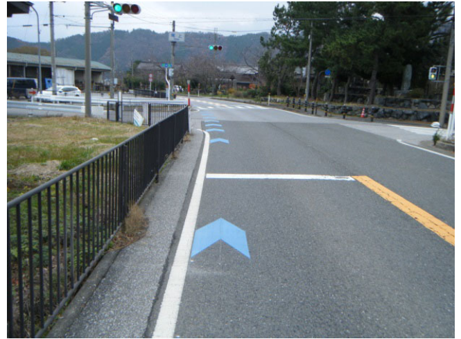
写真3 矢羽型マーク設置状況
