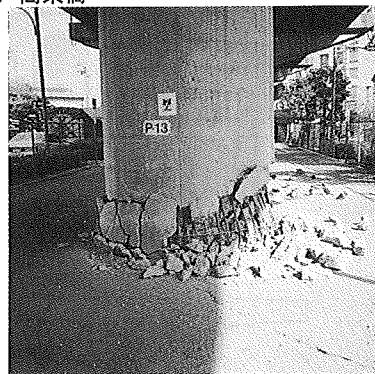
柱基部でのコンクリート剝離、鉄筋のはらみ出し
