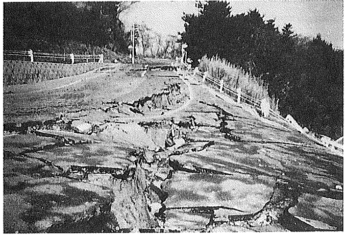
東六甲展望台（4.2km地点）法面及び擁壁が崩壊
