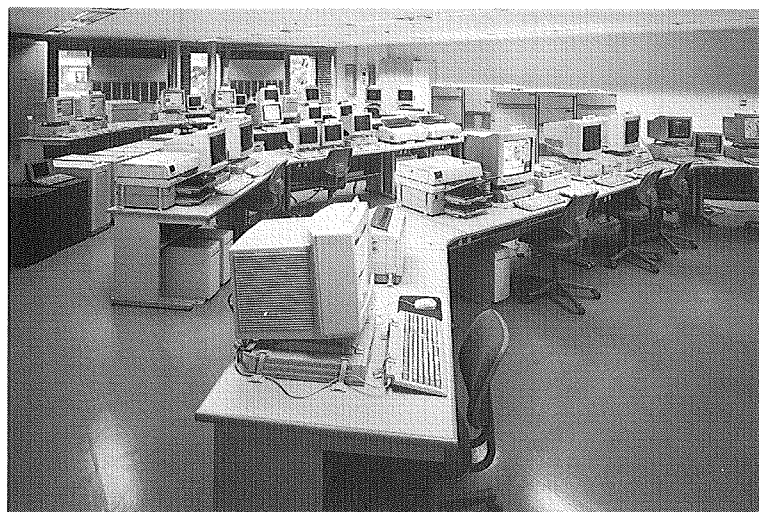
24時間無人稼働中のVICSセンターシステム
