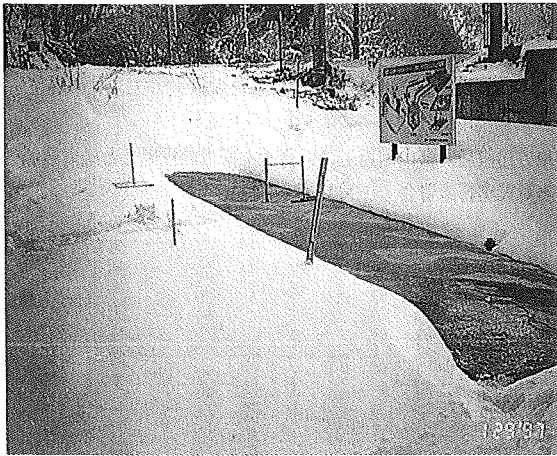
写真7 〔堆肥熱エネルギーによる消融雪施設〕 現地融雪状況
