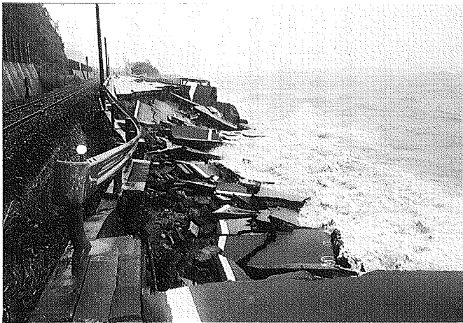
道路決壊状況
