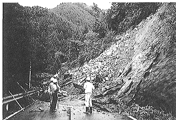
金山明宝線・金山町卵野原 法面崩壊により道路が寸断
