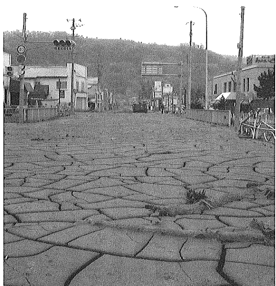
写真4 国道230号の降灰状況
