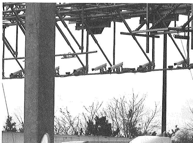
写真6 EXPRESS E-ZPass車線のアンテナ・カメラ
