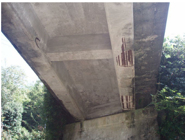
桁の損傷がみられる橋梁
