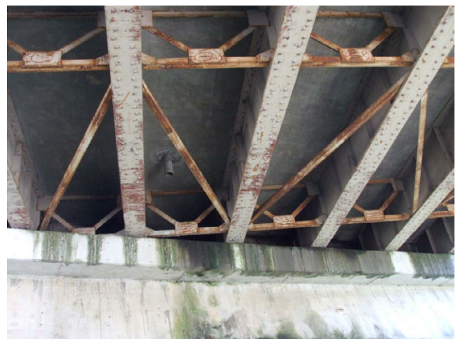
鋼部材に発錆がみられる橋梁
