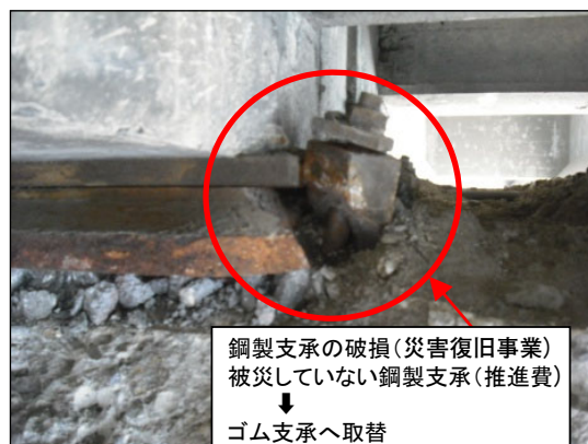
橋脚桁座破損 (災害復旧事業で対応)
