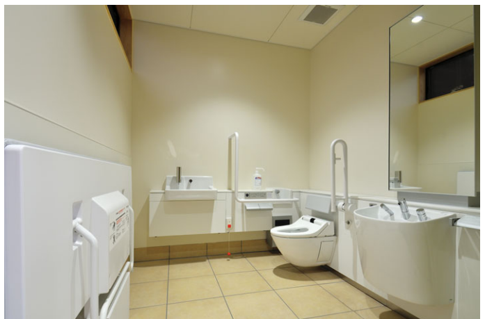
オストメイト設備
