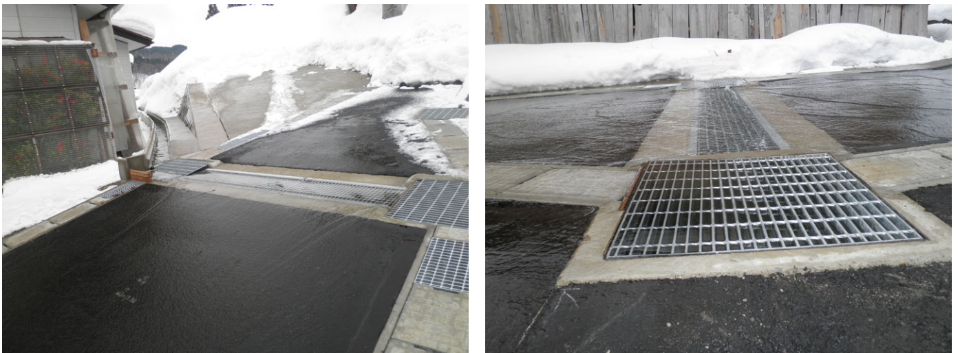
写真3 横断側溝からのオーバーフローにより消雪している状況
