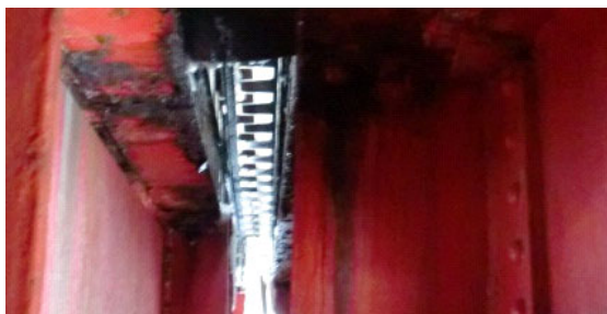
止水材が脱落した伸縮装置
