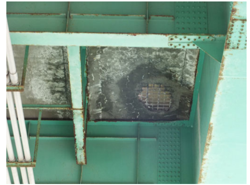
雨水がひび割れから浸透、床版コンクリートが土砂化し抜け落ちた事例。
