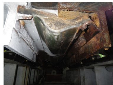
室内試験による止水材の破損状況
