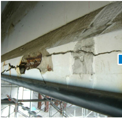
主桁のPC ケーブル及び鉄筋が腐食により破断。 (アウトケーブルにより補強済)
