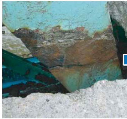
トラス部材の破断はトラス橋にとって重大な損傷。 (破断部は補修済)
