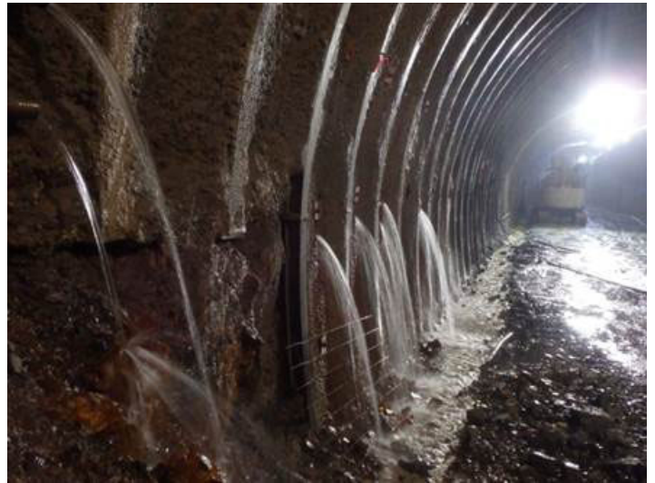
写真1 坑内湧水の様子
