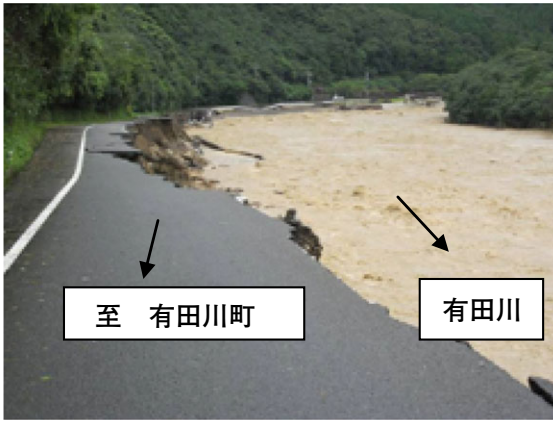
被災直後の一般県道たかの金屋線 (日高川町高津尾地内)
