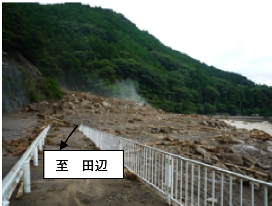
平成 23 年 9 月 4 日被災 被災直後の国道 311 号 (田辺市中辺路町真砂地内)
