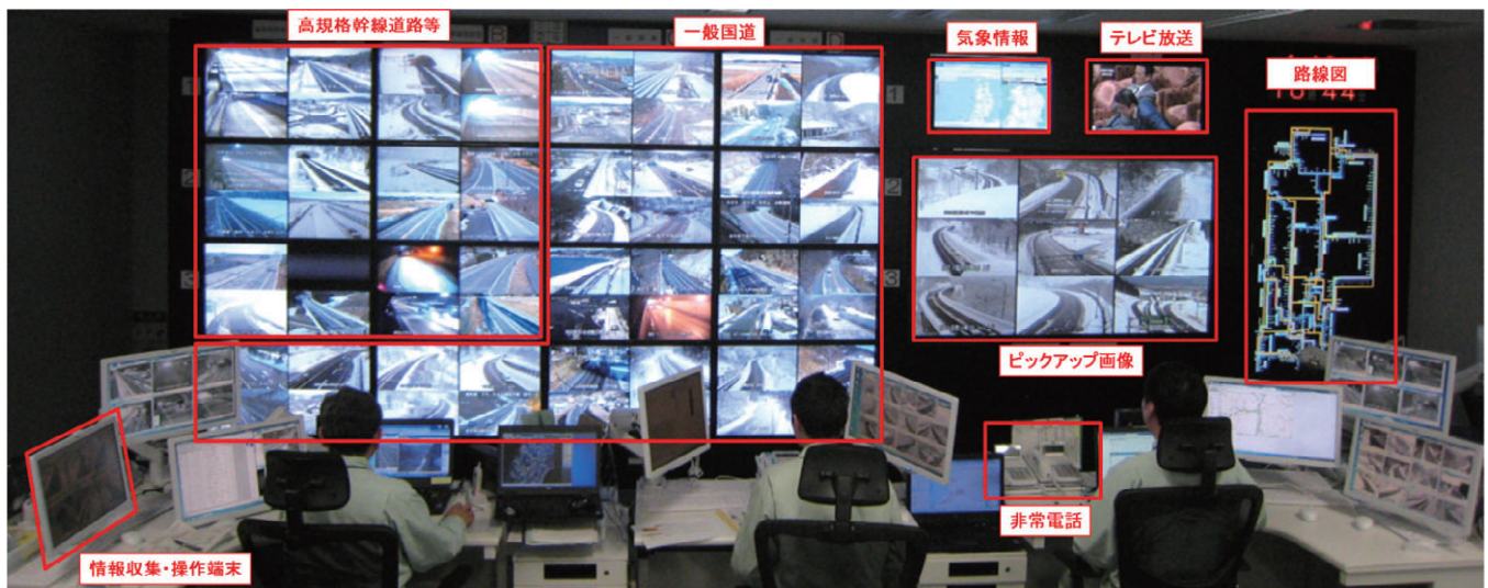
写真-6 高規格道路管理センターにおける情報収集状況
