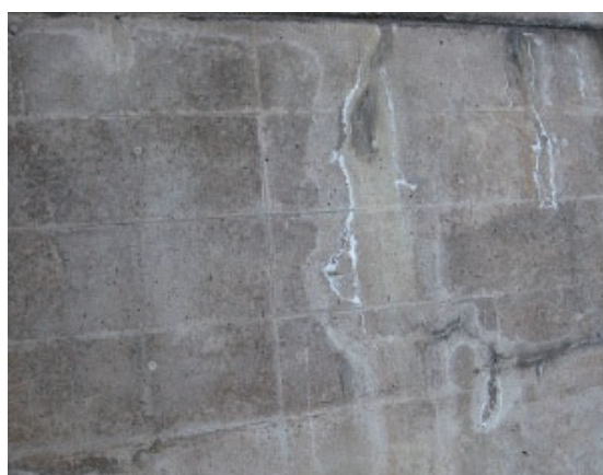
下部工のひび割れ
