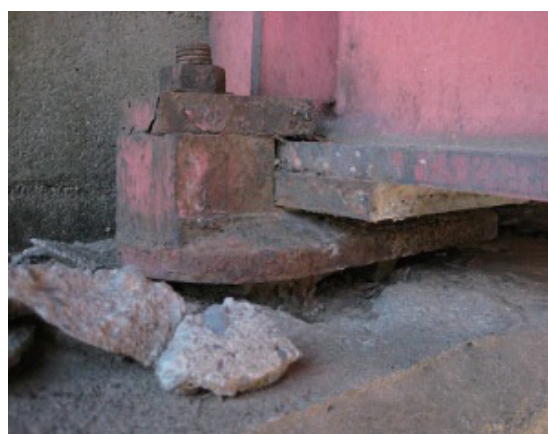
支障の機能障害
