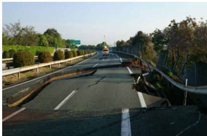
写真－1 益城 BS 付近 盛土のり面崩落
