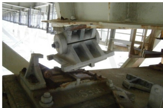
写真－3 並柳橋 支承損傷
