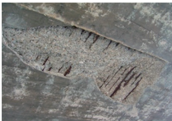
▲ 損傷状況（剥離・鉄筋露出）
