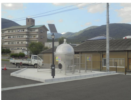
耐震性貯水槽
