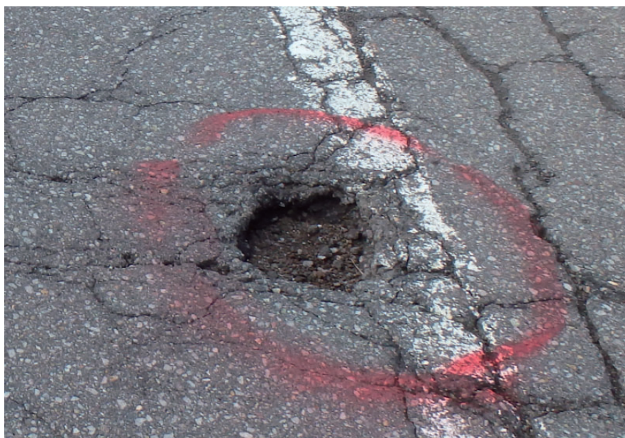
写真1 道路に発生した舗装の穴ぼこ
