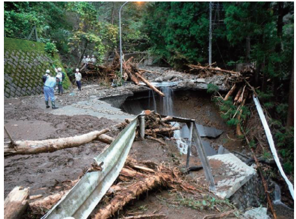
写真-2 被災状況
