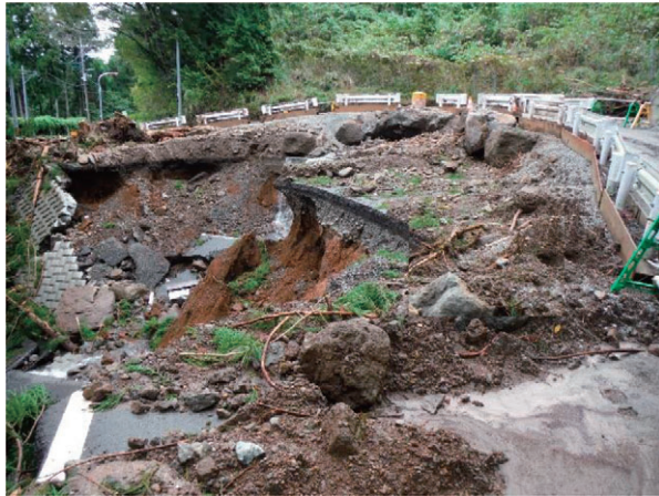
写真-1 被災状況
