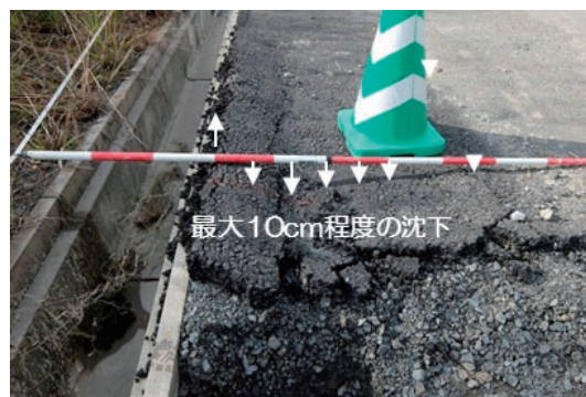
路肩部の沈下発生状況（令和元年 11 月）
