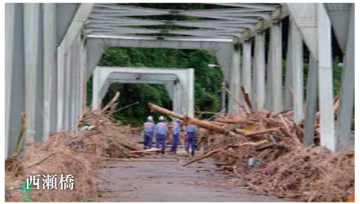
(人吉市西瀬橋被災状況調査)
