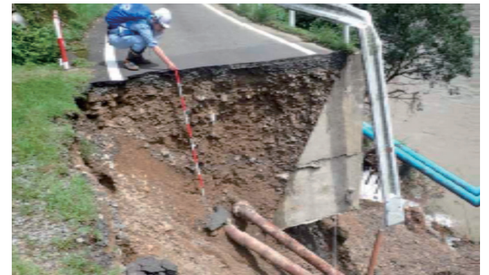
(広域 TEC 被災状況調査)
