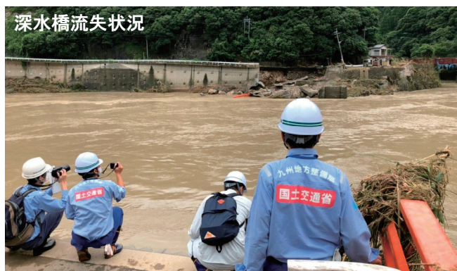
(八代市坂本町深水橋被災状況調査)
