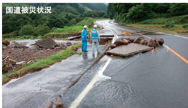
(八代市坂本町被災状況調査)
