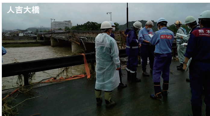
(人吉市人吉大橋被災状況調査)
