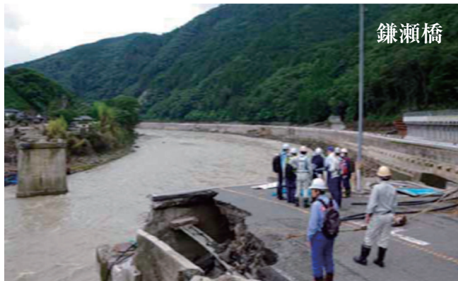
(八代市坂本町鎌瀬橋被災状況調査)
