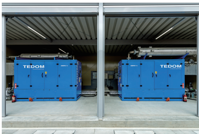
写真-2 ガスエンジン発電機 (85kw × 2 台)
