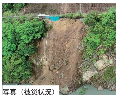
写真（被災状況）
