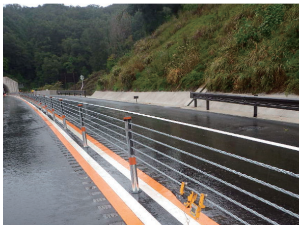
写真-7 ワイヤーロープ式防護柵
