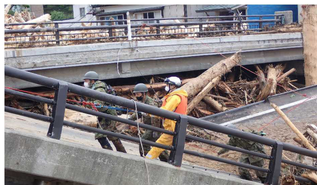
(小赤川橋 被災状況)
