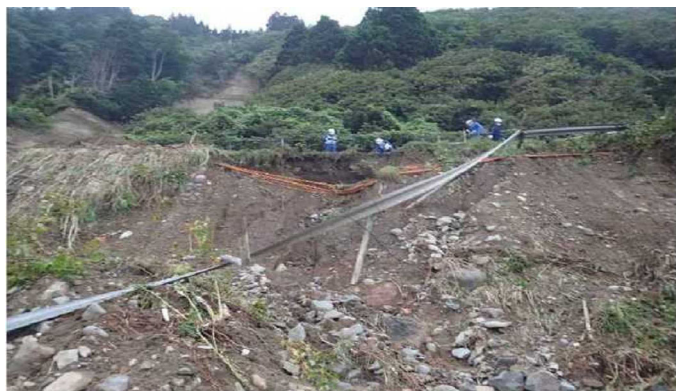
(風間浦村 被災状況調査)
