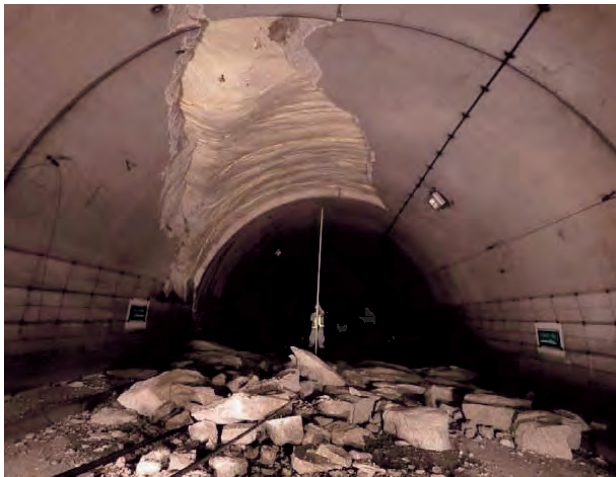
写真4 覆工コンクリートの崩落(俵山トンネル)
