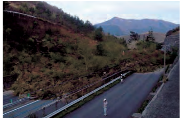
写真2 切土法面の崩落(大分道)
