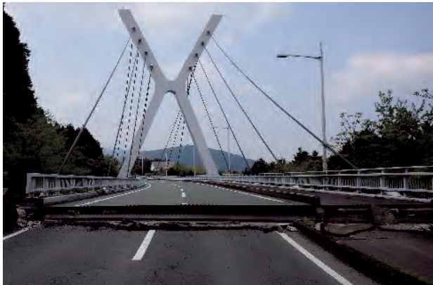
写真5 ケーブルのゆるみ・ぬけ(桑鶴大橋)
