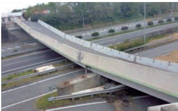
写真1 府領跨道橋の落橋(九州道)
