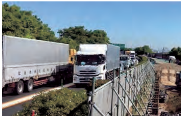
写真7 被災状況(九州道)
