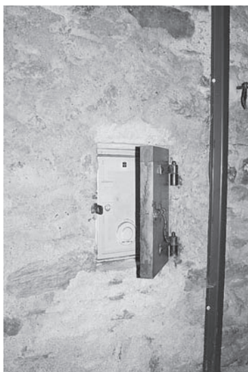
木の扉で隠された配电箱
