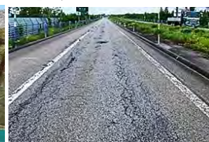
アスファルト路盤の損傷
