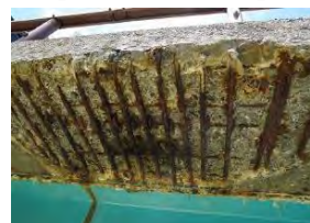
床版鉄筋の露出
