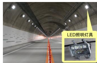
道路照明のLED化
