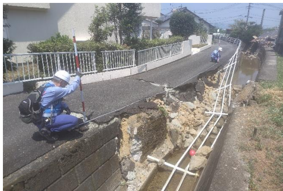
道路の被災状況調査（氷川町）
