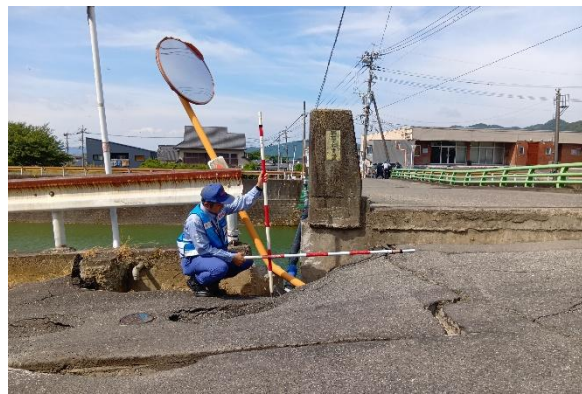
道路の被災状況調査（氷川町）
