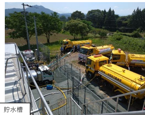
簡易水道貯水槽への給水（嘉島町）
