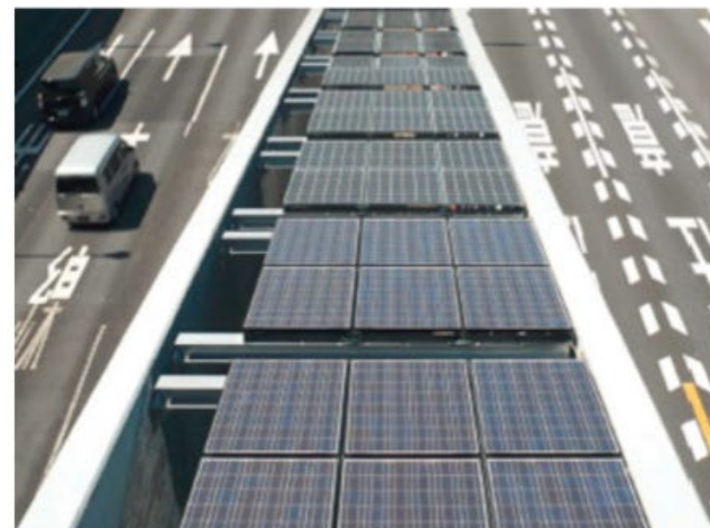
湾岸線東京港トンネル坑口付近太陽光パネル
