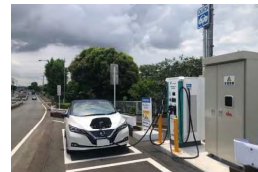
< EV充電器の公道設置(横浜市) >
