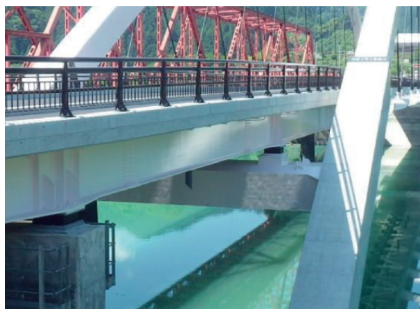
【写真⑦】支承による免震構造
