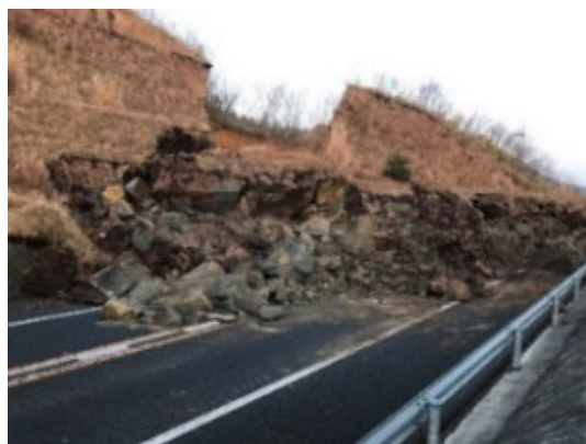
図-2. のり面崩壊による暫定 2 車線区間の通行止め
