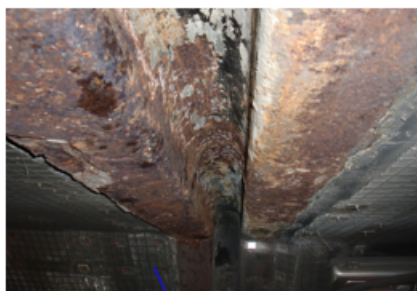
構造目地の腐食・漏水
