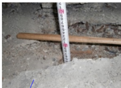
中床版上面のコンクリートはく離
