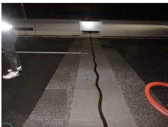
図-6② ジョイントレス化前の状況
