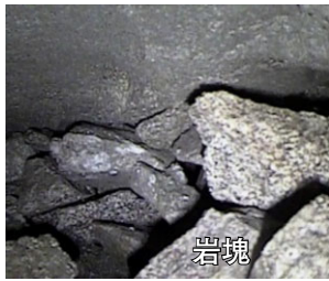
写真2 背面空洞 (空洞最大箇所)
