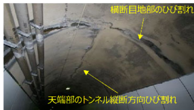
写真5 覆工ひび割れ状況
