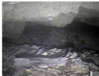
写真3 背面空洞 (覆工欠損箇所)
