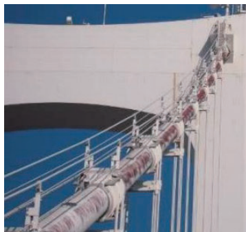
写真-11 塗替え塗装前
