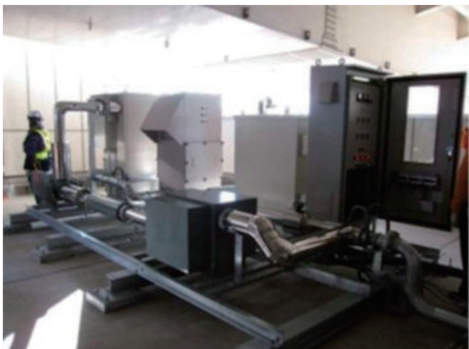
写真-16 アンカレイジに設置した送気システム機器
