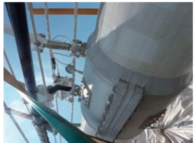
写真-17 主ケーブル送気カバー
