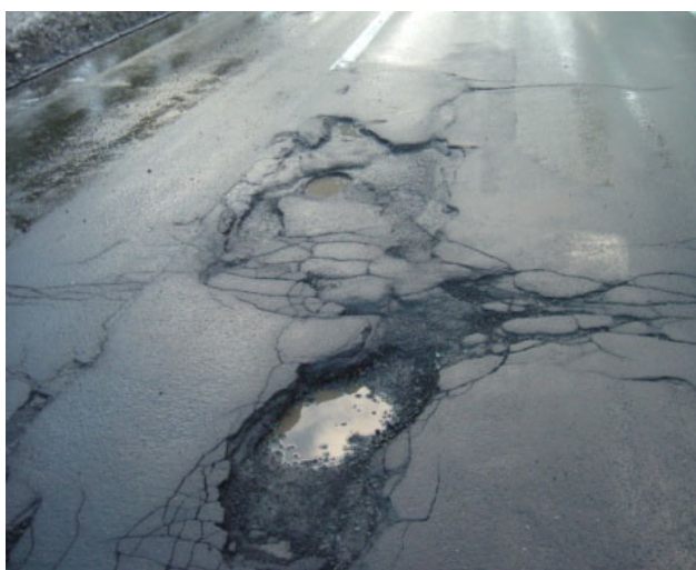
写真1 ポットホール発生状況 (1)
