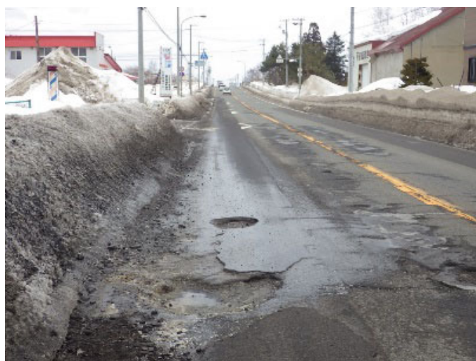
写真2 ポットホール発生状況 (2)
