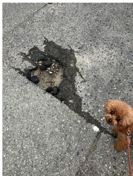
写真－2 路面異状の通報
