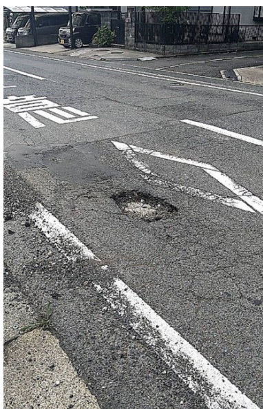
写真－1 路面異状の通報
