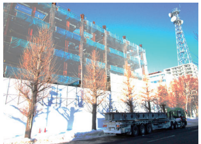
写真 6 札幌開発建設部前の工事現場 （札幌第 4 合同庁舎建設工事）と鉄骨を搬入するスタンションセミトレーラ
