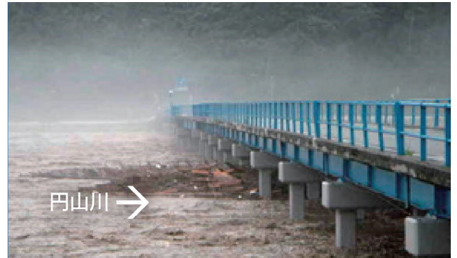
【平成 21 年台風 9 号による状況】
