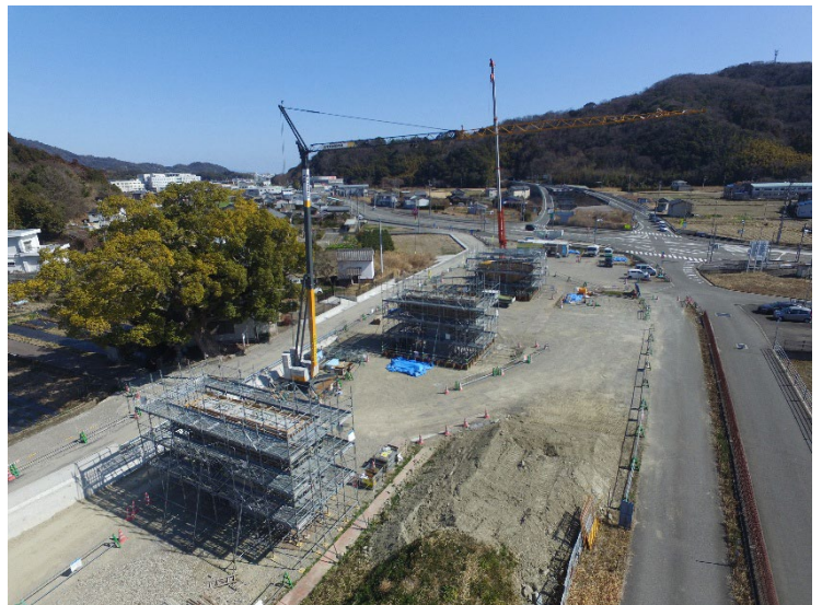
写真-1 定置式水平ジブクレーン施工事例 ※徳島南環状道路（徳島市大木地区）
