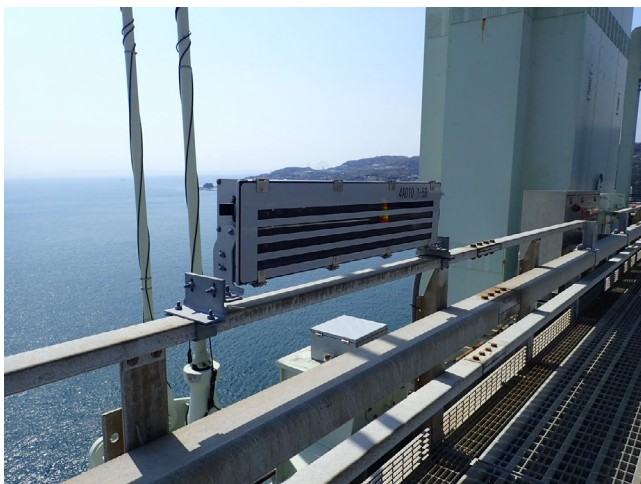
写真-3-(1) 橋梁用広スパン低位置道路照明（昼）
